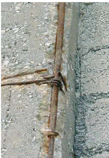
Dotrajalost betonskog pokrova u betonskom stupu.
