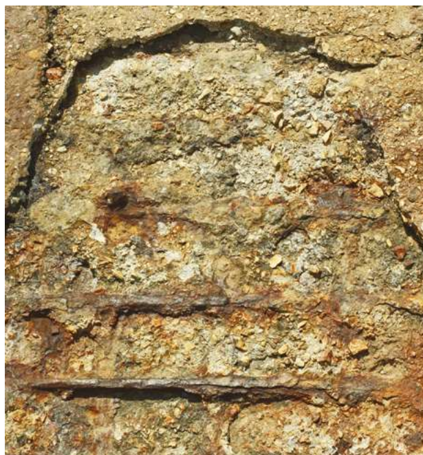
Primjer korozije uslijed napada klorida.
