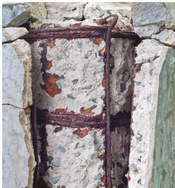
Izbacivanje betonskog pokrova zbog hrđanja armaturnih šipki.
