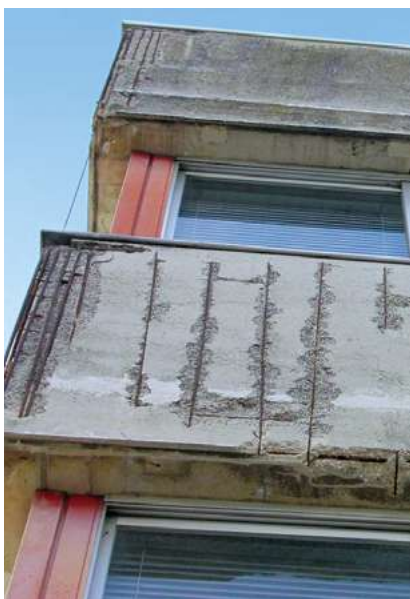
Beton s golim armaturnim šipkama zbog dotrajalosti.
