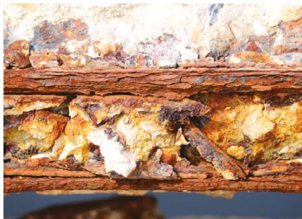
Primjer dotrajalosti betona zbog hrđanja armaturnih šipki.
