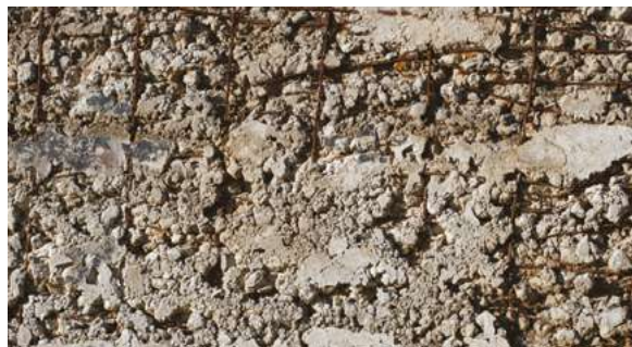
Primjer segregacije agregatā u betonu.
